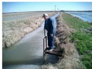
図7 水田(右)への給水施設と用水路(中央)。用水路は土水路。給水施設も簡単なもので、故障しにくく、修理も容易。
