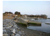
崩壊した防潮堤
